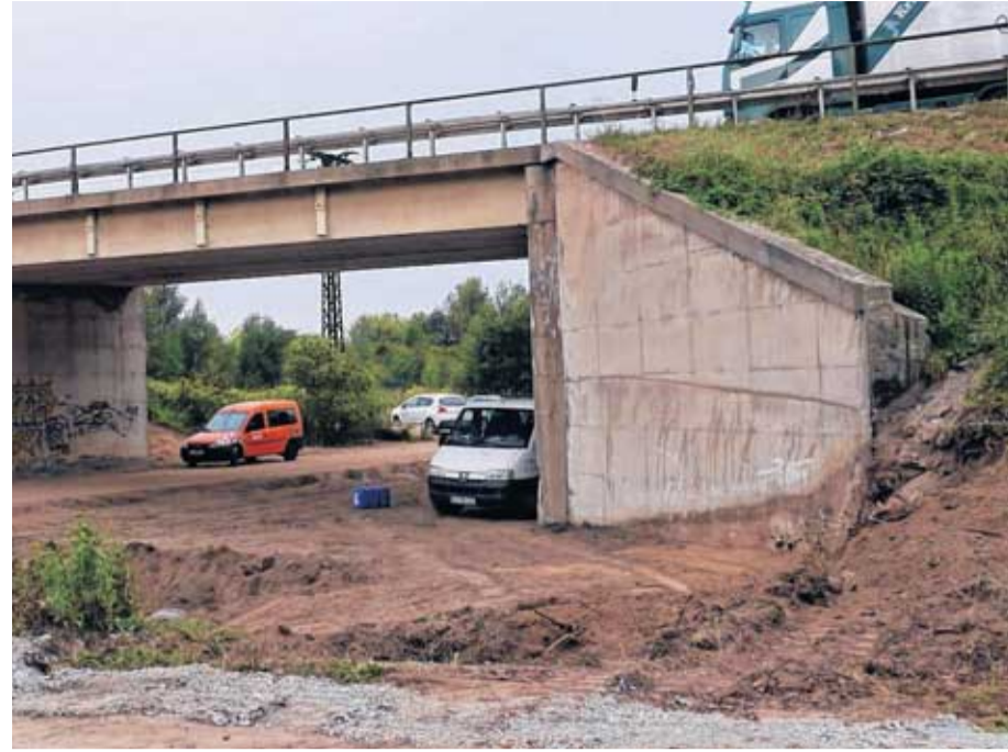
Die Brücke, über welche die Bundesstraße 107 führt, soll abgerissen werden. Die Widerlager sind beschädigt.
